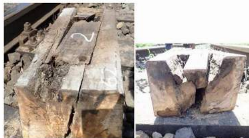
chitul nr. 2 - inimă roșie, crăpături pe fața superioară și crăpătură în adâncime pe lungimea chitului, lemn putrezit pe fața superioară și în interior
