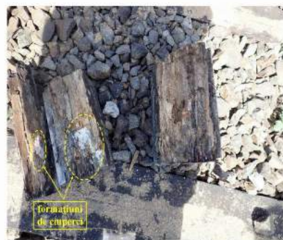
formațiuni de ciuperce și lemn putred în interior
