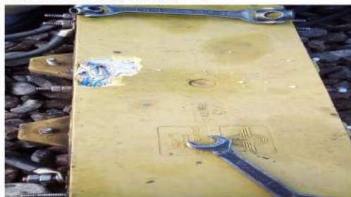
Fotografia nr.2. Bobina de joantă afectată;
