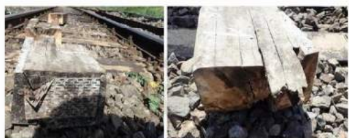
chitul nr. 1 – inimă roșie, crăpături pe fața superioară și în adâncime, putrezire la partea inferioară
