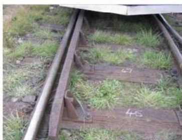
Foto nr.5.– Numerotarea traversei pe schimbătorul de cale nr.59A
