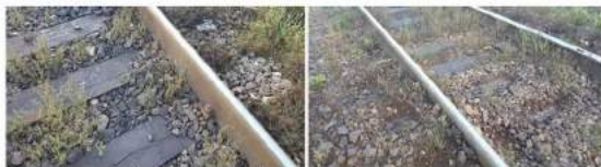
Zone cu piatră spartă și vegetație care împiedică vizualizarea stării tehnice a traversei în zona de fixare a plăcilor metalice
