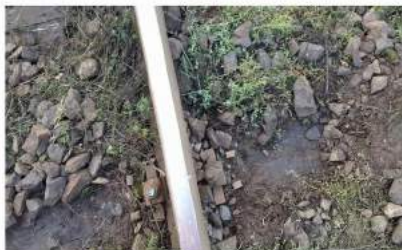
Traversa nr. +1 – primul șurub vertical lovit capătul traversei corespunzător șinei din partea dreaptă a sensului de mers (firul interior al curbei)
